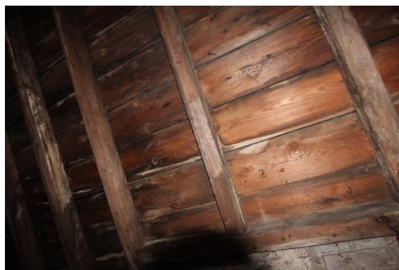
Staat van bevinding: bebording en kepers
