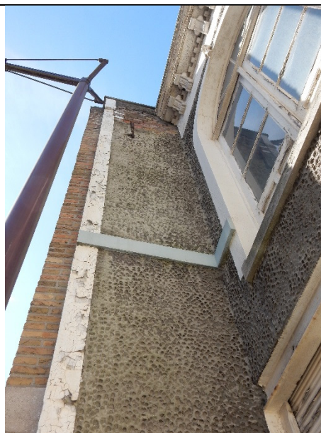
Rotsbepleistering tegen zijgevel buur: los en weg
