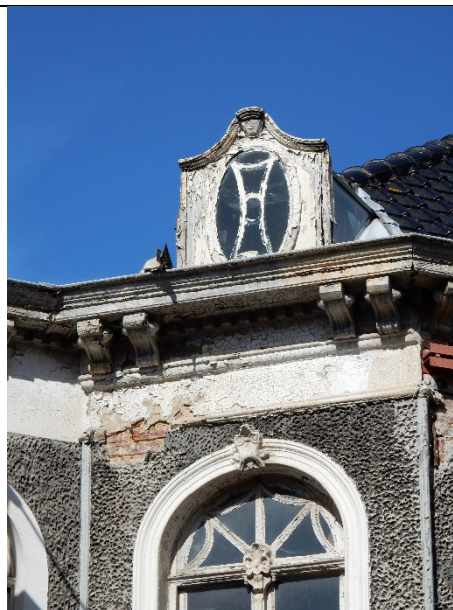
Lijst: pleister weg, schrale verf Rotsbepleistering: los en weg Dakkapellen: deel hout los en in goot, verf zeer schraal; structuur binnen aangetast (cfr zolder)
