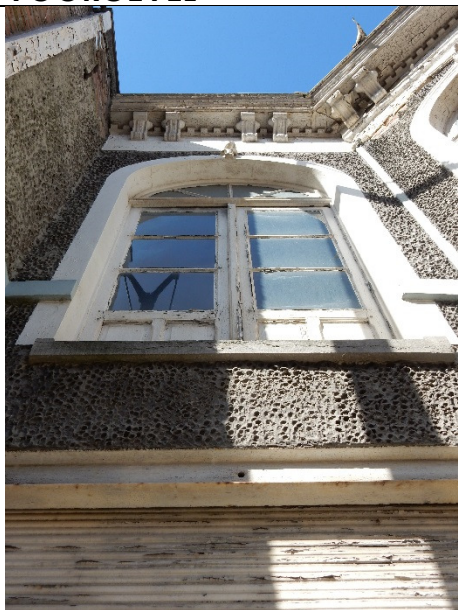
Rotsbepleistering: op zijmuur buur weg Houten schrijnwerk: schrale verf
