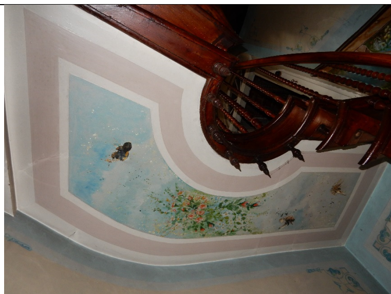
Plafond in middenste deel
