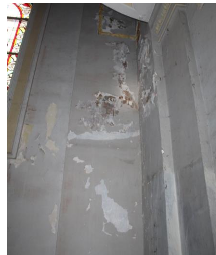
Vooraf in de noord- en zuidwestelijke hoeken hebben muren te maken met sterke afschilferingen waardoor onderliggende marmerimitaties fragmentair tevoorschijn zijn gekomen.
