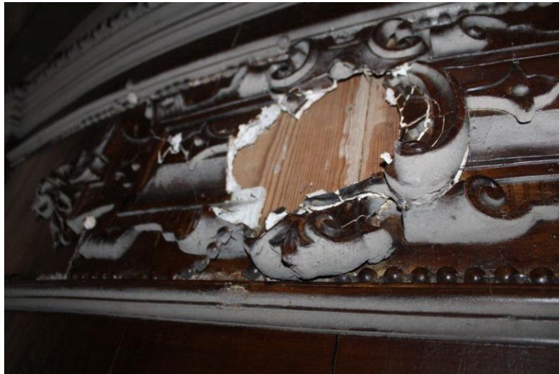
Een onderdeel (vermoedelijk een engelenkopje) van de centrale cartouche van de borstwering is afgebroken, verdwenen. Merk de dennenhouten structuur op , waarop het stucwerk werd aangebracht.
