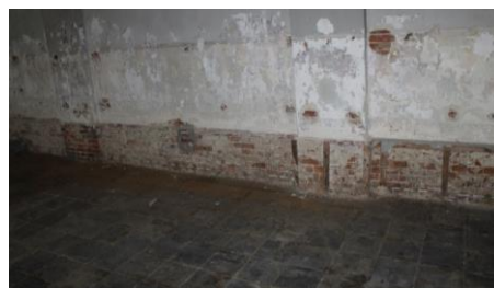
Alle houten lambriseringen werden verwijderd vermoedelijk doordat het hout aangetast was door zwammen.
