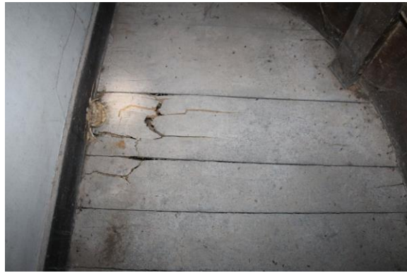
Door zwamaantastingen en vocht is het hout hier van de plankenvloer van de tribune, structureel aangetast.
