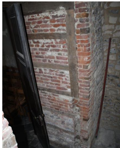
De houten deuromkadering langs de kant van het portaal zijn verwijderd. Houten structurele elementen ingemetseld in de muren zijn eveneens gedeeltelijk verwijderd omwille van aantastingen.
