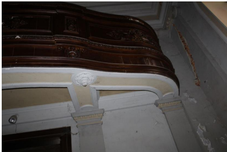
In de onderbouw van de borstwering, vooral aan de noordelijke zijde, duiken er opstuwingen op in de pleisterlaag, zonder twijfel veroorzaakt door zwamaantastingen verscholen in de onderliggende structuur.
