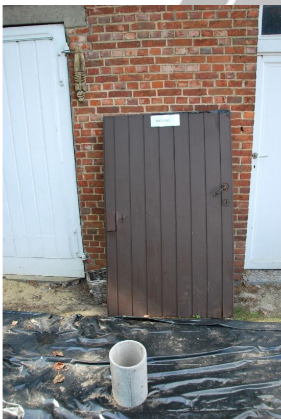
Situering: Koersel I Pastorie. Beschrijving: Interieur I Nivo 0 I Ruimte 0.15. Bron: Architectenburo Erik Martens & Partners I 2019.
