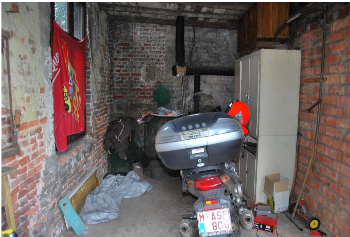
Situering: Koersel I Pastorie. Beschrijving: Interieur I Nivo 0 I Ruimte 0.15. Bron: Architectenburo Erik Martens & Partners I 2019.
