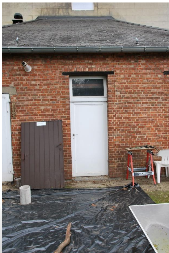
Situering: Koersel I Pastorie. Beschrijving: Extérieur I Zijgevel rechts (detail buitenschrijnwerk). Bron: Architectenburo Erik Martens & Partners I 2019.
