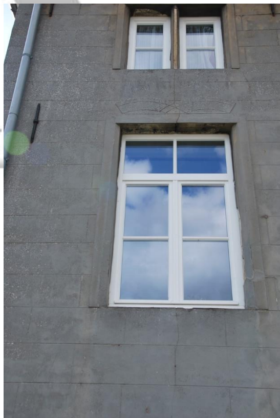
Situering: Koersel I Pastorie. Beschrijving: Extérieur I Voorgevel (detail buitenschrijnwerk). Bron: Architectenburo Erik Martens & Partners I 2019.
