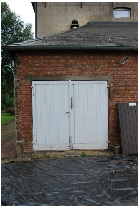
Situering: Koersel I Pastorie. Beschrijving: Extérieur I Zijgevel rechts (detail buitenschrijnwerk). Bron: Architectenburo Erik Martens & Partners I 2019.
