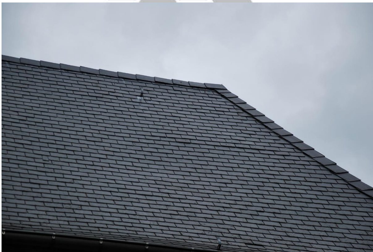
Situering: Koersel I Pastorie. Beschrijving: Extérieur I Voorgevel (detail dak). Bron: Architectenburo Erik Martens & Partners I 2019.
