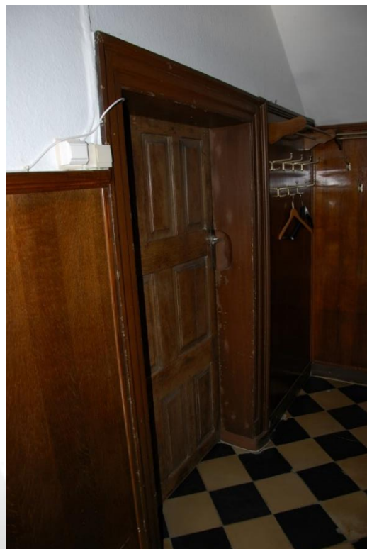
Situering: Koersel | Pastorie. Beschrijving: Interieur | Nivo 0 | Ruimte 0.4. Bron: Architectenburo Erik Martens & Partners | 2019.
