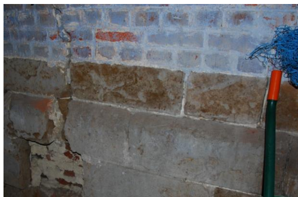
Interieur | Ruimte 0.12 | Plint met dichtgezet kelderraam.
