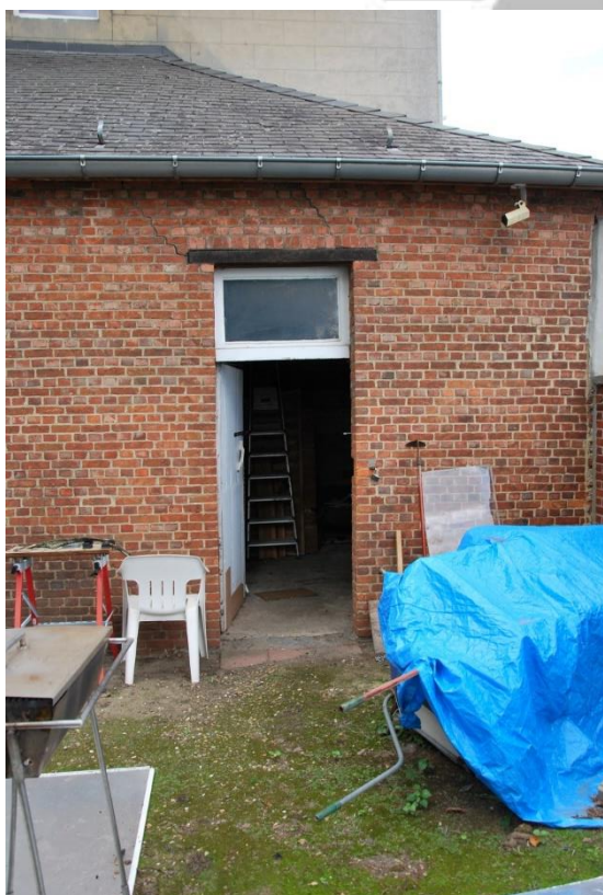
Situering: Koersel I Pastorie. Beschrijving: Extérieur I Zijgevel rechts (detail buitenschrijnwerk). Bron: Architectenburo Erik Martens & Partners I 2019.
