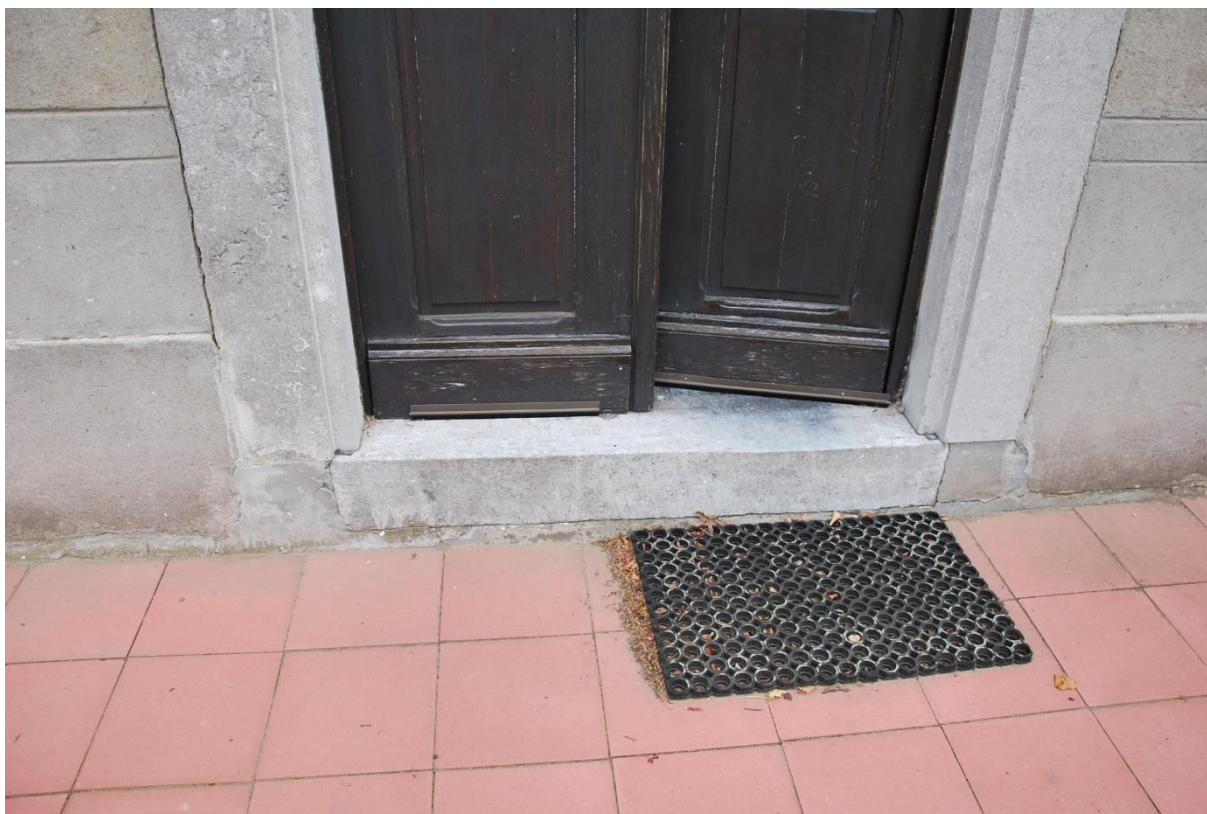
Situering: Koersel I Pastorie. Beschrijving: Extérieur I Voorgevel (detail inkomdeur). Bron: Architectenburo Erik Martens & Partners I 2019.
