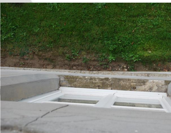
Achterevel I Voormalig kruisvenster I Onderdorpel en gaten diefijzers.
