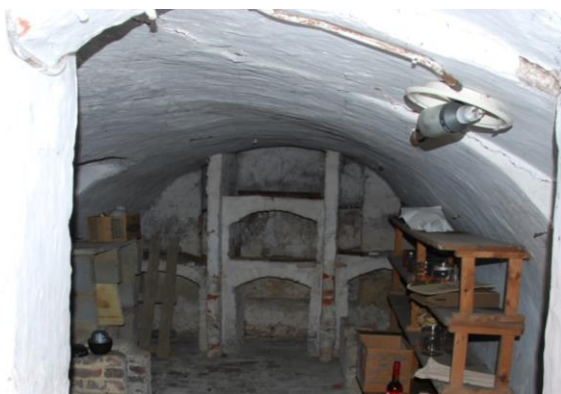
Interieur | Kelder | Scheur in keldergewelf.
