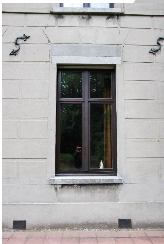
Situering: Koersel I Pastorie. Beschrijving: Extérieur I Voorgevel (detail buitenschrijnwerk). Bron: Architectenburo Erik Martens & Partners I 2019.
