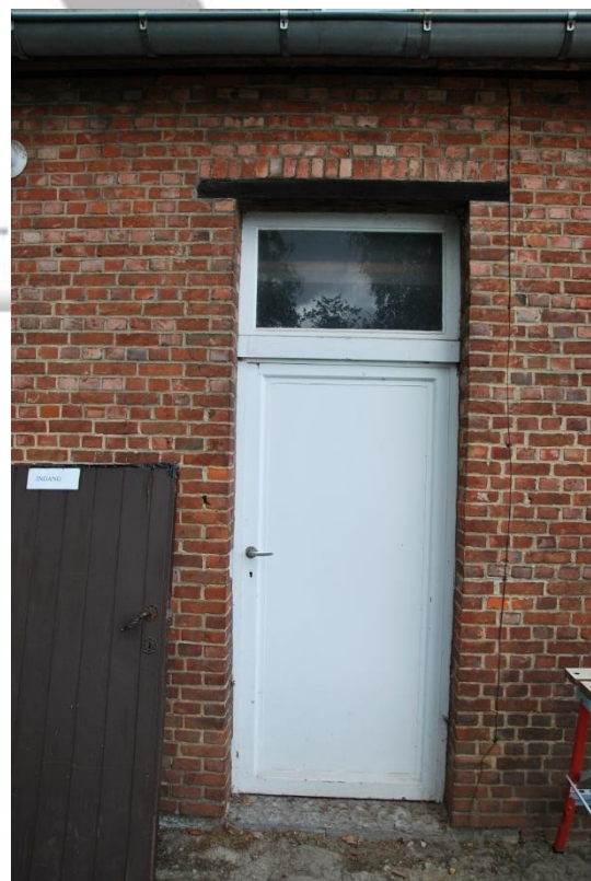
Situering: Koersel I Pastorie. Beschrijving: Interieur I Nivo 0 I Ruimte 0.13. Bron: Architectenburo Erik Martens & Partners I 2019.
