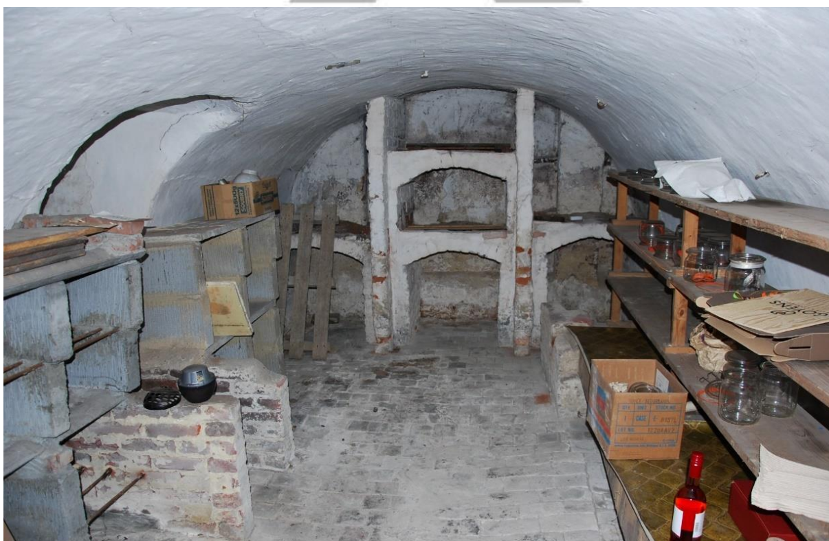
Situering: Koersel | Pastorie. Beschrijving: Interieur | Nivo -1 | Ruimte -1.1. Bron: Architectenburo Erik Martens & Partners | 2019.
