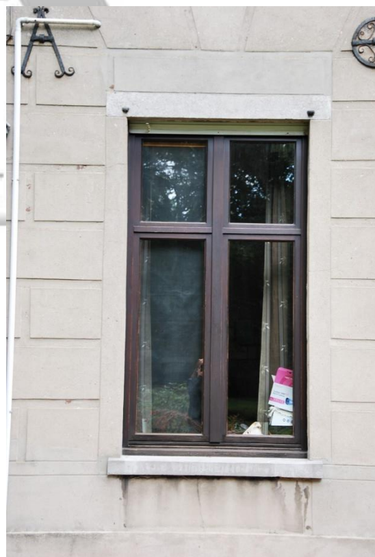
Situering: Koersel I Pastorie. Beschrijving: Extérieur I Voorgevel (detail buitenschrijnwerk). Bron: Architectenburo Erik Martens & Partners I 2019.
