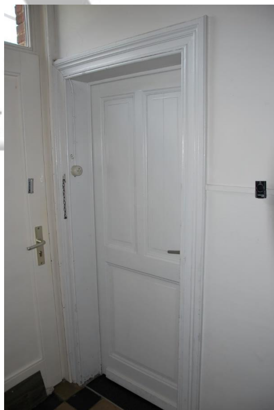
Situering: Koersel I Pastorie. Beschrijving: Interieur I Nivo 0 I Ruimte 0.7. Bron: Architectenburo Erik Martens & Partners I 2019.
