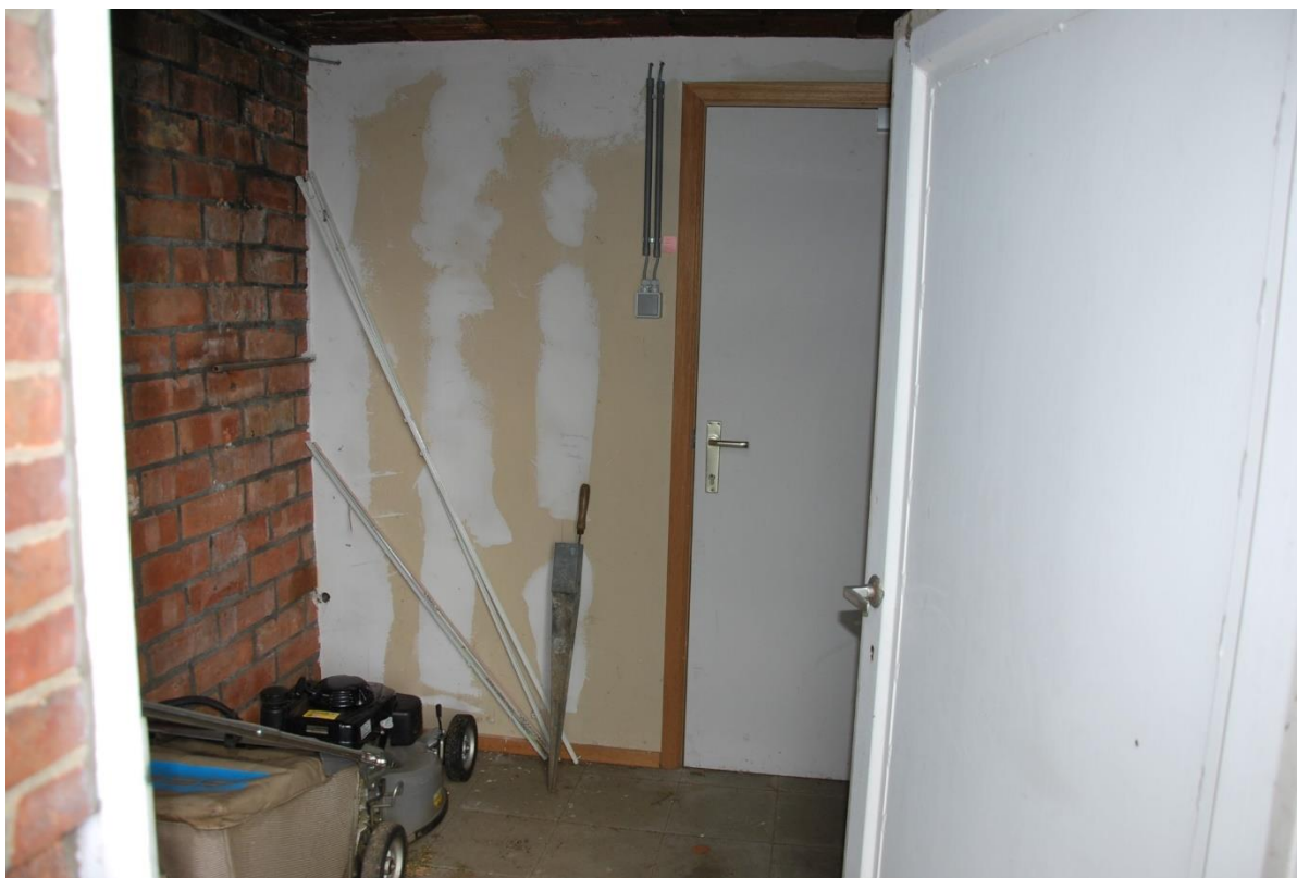
Situering: Koersel I Pastorie. Beschrijving: Interieur I Nivo 0 I Ruimte 0.13. Bron: Architectenburo Erik Martens & Partners I 2019.
