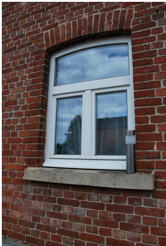
Situering: Koersel I Pastorie. Beschrijving: Extérieur I Zijgevel links (detail buitenschrijnwerk). Bron: Architectenburo Erik Martens & Partners I 2019.
