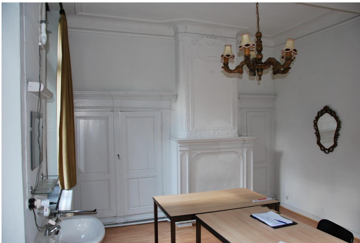
Situering: Koersel | Pastorie. Beschrijving: Interieur | Nivo 1 | Ruimte 1.4. Bron: Architectenburo Erik Martens & Partners | 2019.
