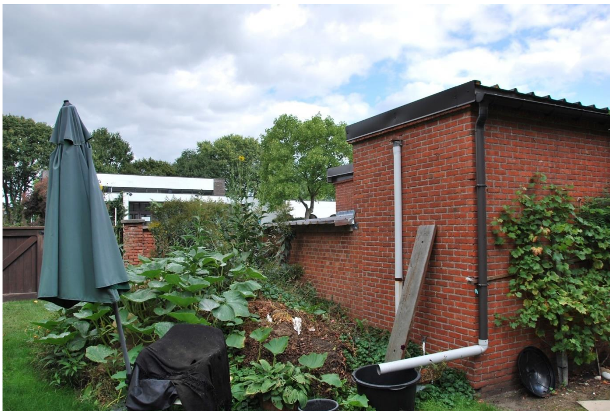
Situering: Koersel | Pastorie. Beschrijving: Extérieur | Zijgevel links (zicht vanaf de tuin). Bron: Architectenburo Erik Martens & Partners | 2019.
