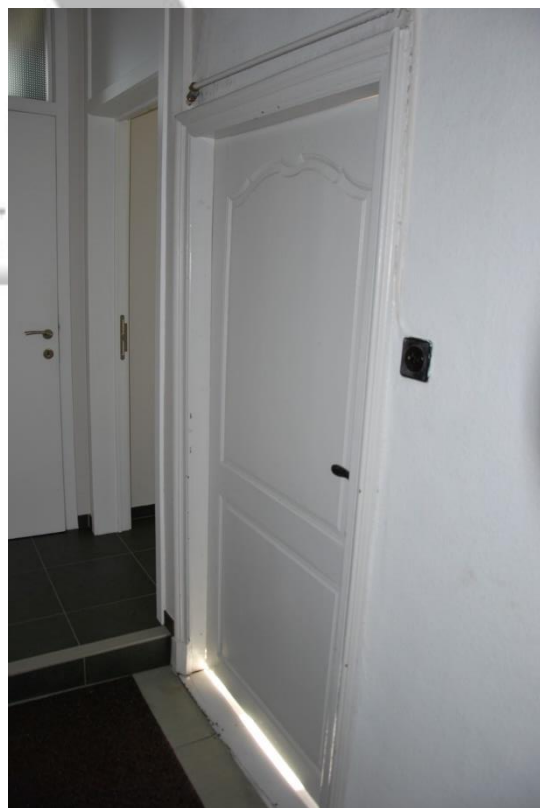
Situering: Koersel I Pastorie. Beschrijving: Interieur I Nivo 1 I Ruimte 1.6. Bron: Architectenburo Erik Martens & Partners I 2019.
