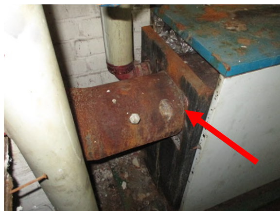
LRK17/3: Koord aan stookketel, bevat asbest Achterzijde t.h.v. rookgasafvoerbuiss
