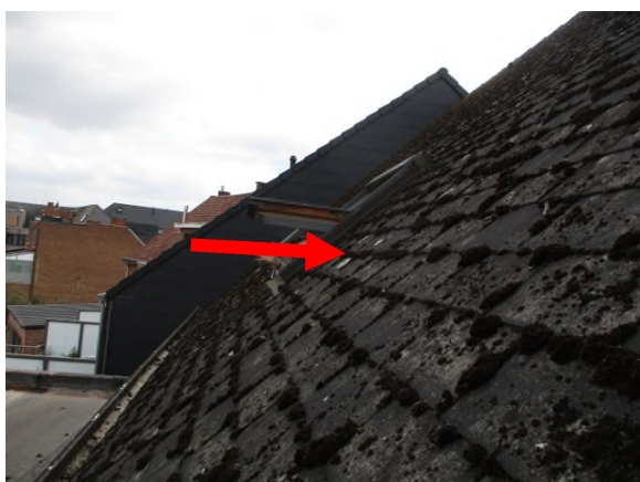
LRK17/1: Dakleien in asbestcement Sterk verweerd + mos
