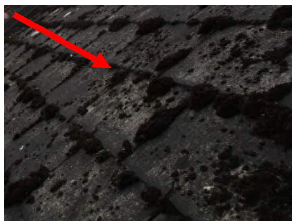
LRK17/1: Dakleien in asbestcement Sterk verweerd + mos
