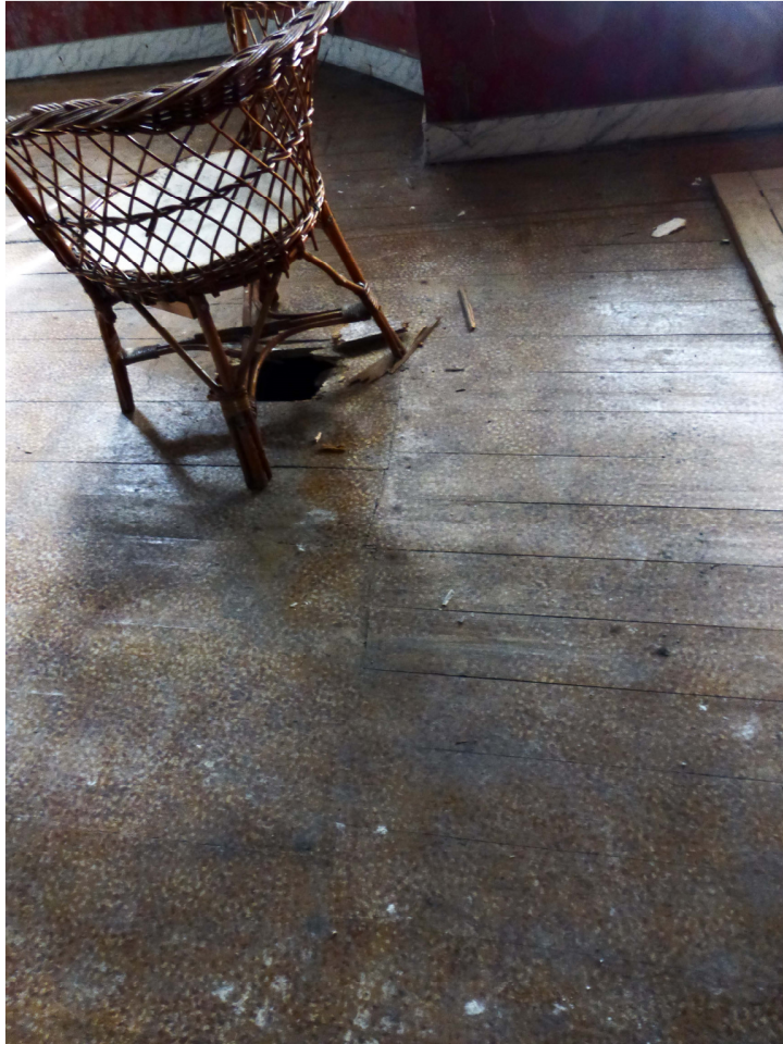
Bouwnaad in de vloer tussen het oorspronkelijke gedeelte en de latere aanbouw
