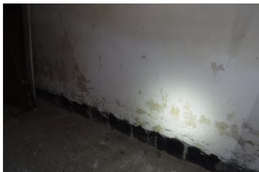
Schade door opstijgend vocht en zouten.
